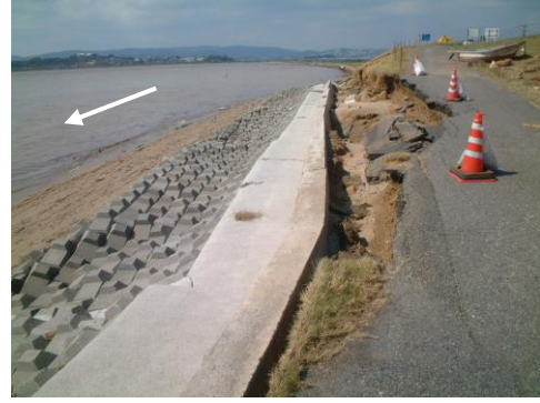
平成16年台風16号の被災状況 (高梁川左岸・倉敷市鶴新田)
