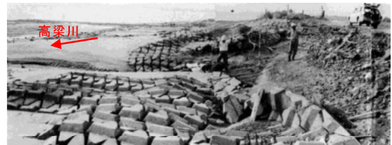
倉敷市鶴新田 低水護岸被災
