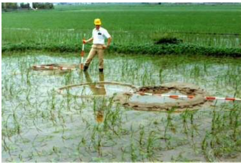
砂の噴出に伴う陥没の発生状況（昭和60年6月洪水） 位置：倉敷市真備町
