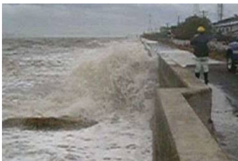
高梁川の高潮越波状況（平成16年台風16号） 位置：倉敷市玉島乙島地区
