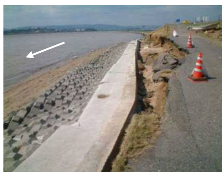
平成16年台風16号の被災状況 (高梁川左岸・倉敷市鶴新田)
