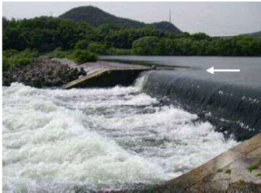
笠井堰（固定堰）
