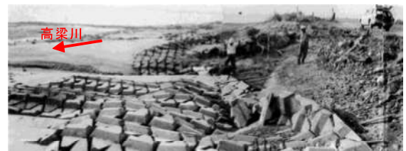
倉敷市鶴新田 低水護岸被災
