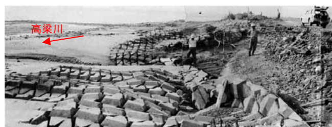
倉敷市鶴新田 低水護岸被災状況
