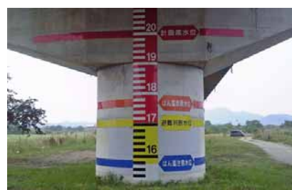
橋脚への水位表示状況(高梁川)
