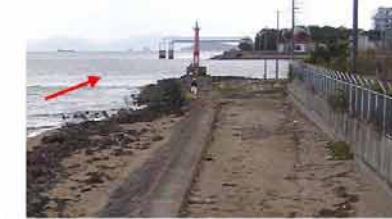
堤防の未整備区間の状況(高梁川河口付近)
