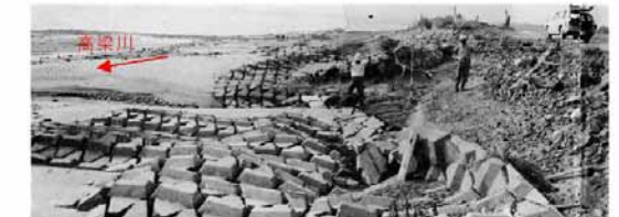
倉敷市鶴新田 低水護岸被災状況 出典：昭和 47 年 7 月豪雨災害誌（中国地方建設局） 高梁川の被災状況（昭和 47 年 7 月洪水）
