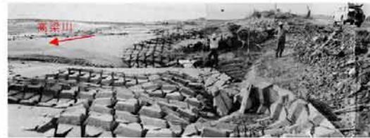
倉敷市鶴新田 低水護岸被災状況 出典：昭和 47 年 7 月豪雨災害誌（中国地方建設局） 高梁川の被災状況（昭和 47 年 7 月洪水）
