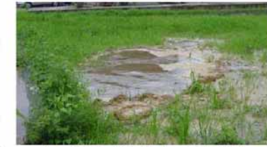
砂の噴出に伴う陥没の発生状況（H18.7 洪水、総社市清音地区） 洪水時に、堤防基盤からの漏水により、堤防から離れた所で水と土砂が吹き出したもの。
