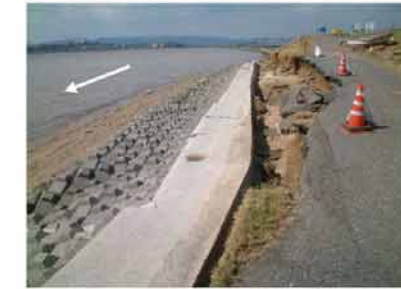
平成16年台風16号の被災状況 (高梁川左岸・倉敷市鶴新田)
