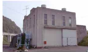
軽部排水機場
