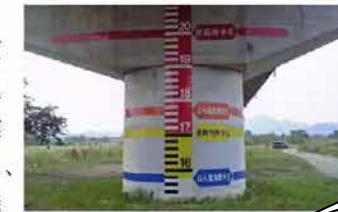
橋脚への量水標の設置状況(高梁川)
