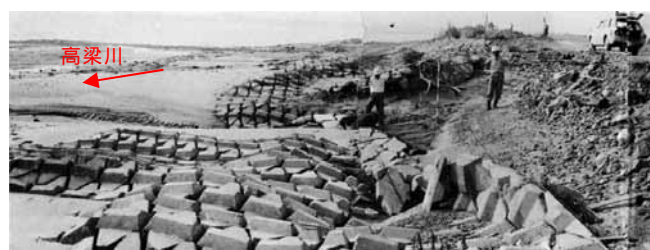
倉敷市鶴新田 低水護岸被災状況
