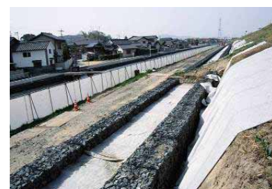
堤防補強におけるドレーン部の施工状況(高梁川10.2k左岸側、倉敷市酒津地先)
