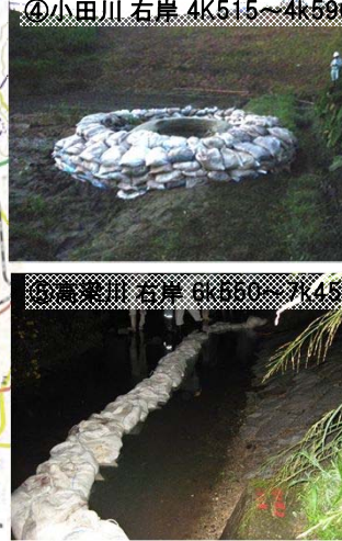
高梁川・小田川で漏水被害が発生し水防活動を実施している
