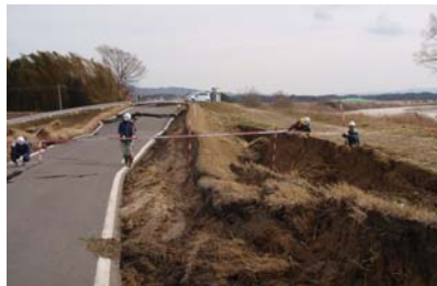
東北地方太平洋沖地震による堤防沈下の事例(阿武隈川坂津田地区) 提供:東北地方整備局
