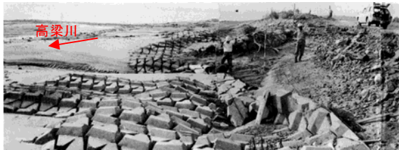
倉敷市鶴新田 低水護岸被災
