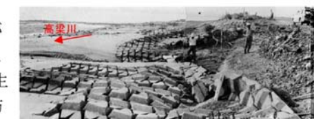
倉敷市鶴新田 低水護岸被災
