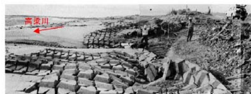
倉敷市鶴新田 低水護岸被災状況
