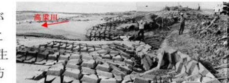
倉敷市鶴新田 低水護岸被災 出典：昭和 47 年 7 月豪雨災害誌（中国地方建設局） 高梁川の被災状況（昭和 47 年 7 月洪水）
