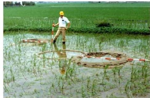
位置：倉敷市真備町 基盤漏水によるガマの発生状況（昭和60年6月洪水）
