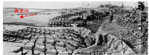
倉敷市鶴新田 低水護岸被災状況 出典：昭和 47 年 7 月豪雨災害誌（中国地方建設局） 高梁川の被災状況（昭和 47 年 7 月洪水）
