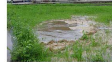
砂の噴出に伴う陥没の発生状況 (H18.7 洪水、総社市清音地区) 洪水時に、堤防基盤からの漏水により、堤防から離れた所で水と土砂が吹き出したもの。
