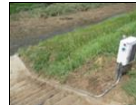
危機管理型水位計の設置状況
