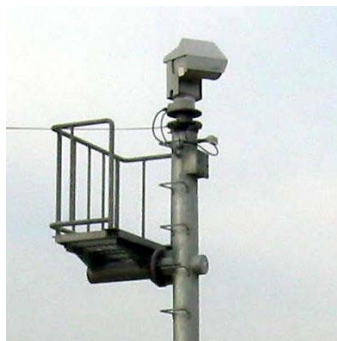
河川監視カメラ
