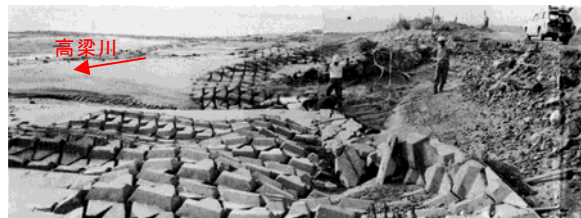
倉敷市鶴新田 低水護岸被災
