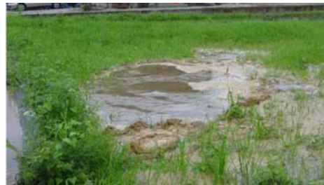
砂の噴出に伴う陥没の発生状況
