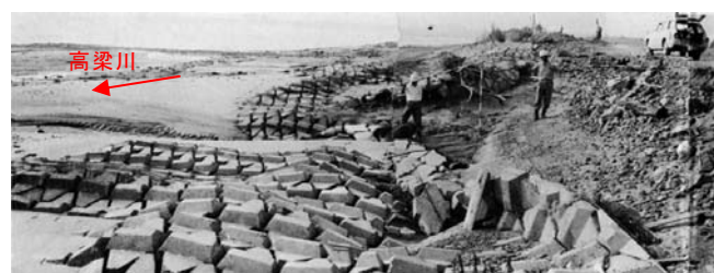
倉敷市鶴新田 低水護岸被災状況
