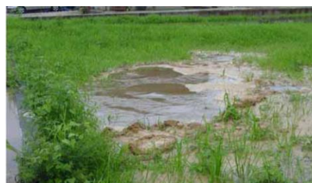
砂の噴出に伴う陥没の発生状況 (H18. 7 洪水、総社市清音地区) 洪水時に、堤防基盤からの漏水により、堤防から離れた所で水と土砂が吹き出したもの。
