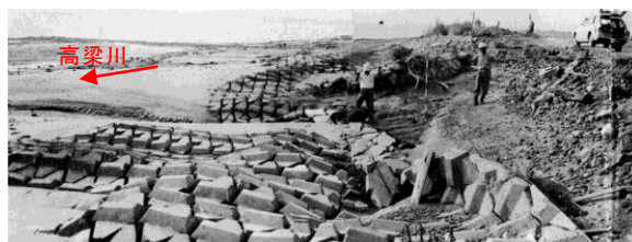
倉敷市鶴新田 低水護岸被災
