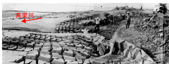
倉敷市鶴新田 低水護岸被災
