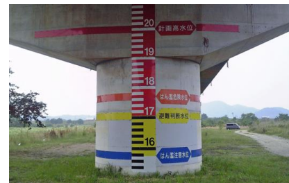
橋脚への量水標の設置状況 (高梁川)
