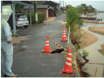
写真2.1.2 高潮被害状況 (平成16年8月：西幸西地先)
