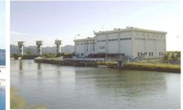
写真 2.1.4 乙子排水機場 (昭和54年完成、平成6年増設)
