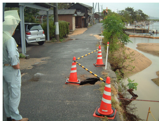
写真 2.1.2 高潮被害状況 (平成16年8月：西幸西地先)
