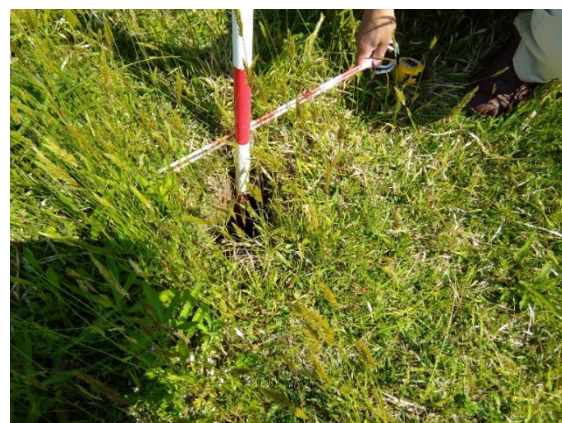
低水護岸の陥没状況(吉井川)
