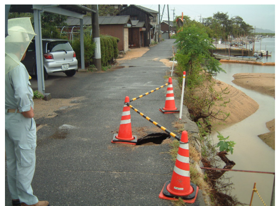
写真 2.1.2 高潮被害状況 (平成16年8月：西幸西地先)
