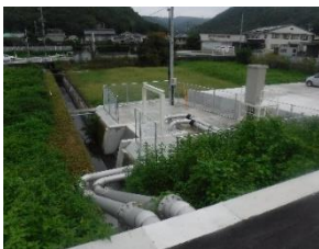
西町排水ポンプ場
