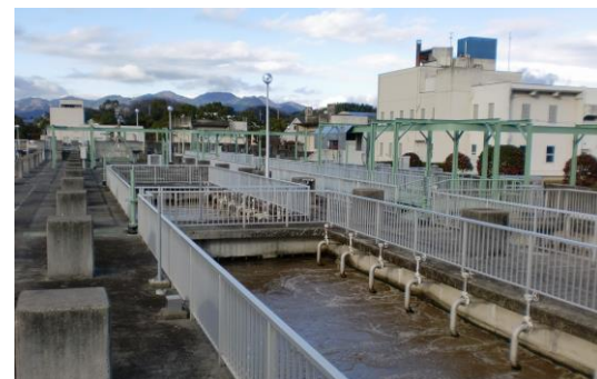
津山浄化センター
