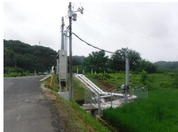
首高排水ポンプ場
