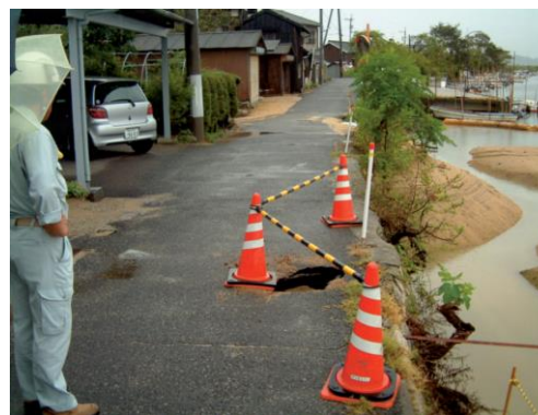
高潮被害状況 (平成16年8月:西幸西地先)
