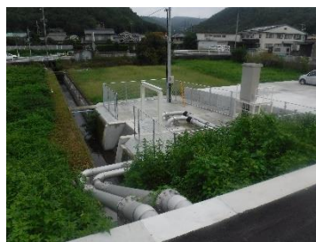
西町排水ポンプ場 (R3新設)
