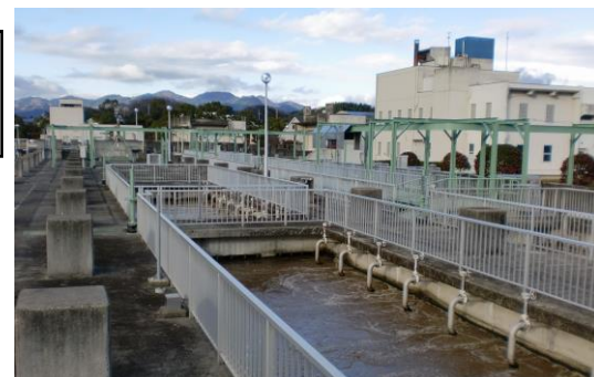
津山浄化センター
