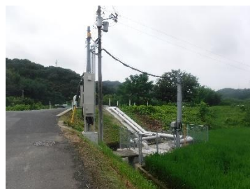
首高排水ポンプ場 (R3増設)
