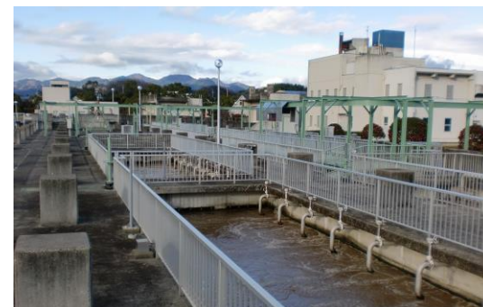
津山浄化センター
