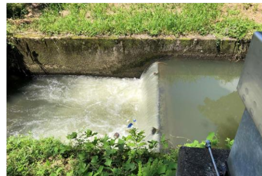
古地取水転倒堰の事前操作
