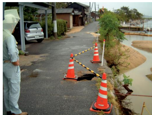
高潮被害状況 (平成16年8月:西幸西地先)
