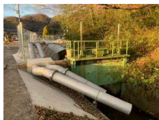
伊賀寺排水ポンプ場
