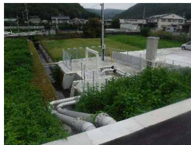
西町排水ポンプ場 (R3新設)
