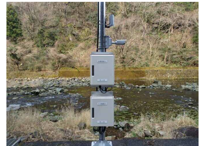
簡易型河川監視カメラ
