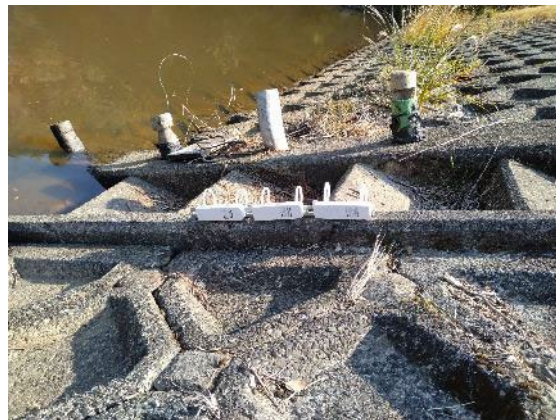
センサー設置状況(ため池)
