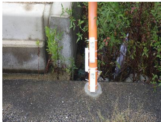
センサー設置状況 (浸水多発箇所)
