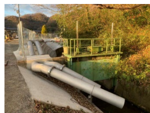
伊賀寺排水ポンプ場
