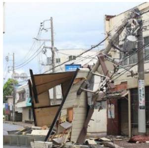
＜飛来物による電柱倒壊の事例＞
