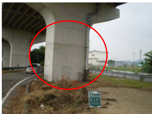
橋脚補強（RC巻立）【対策前】
