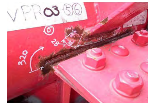
写真-1.5 下弦材とガセットの接合部 (VPR03⑦⑧) および下弦材とニーブレース接合部 (⑤⑥)
