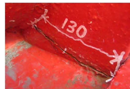
写真-4.2 亀裂発生状況
