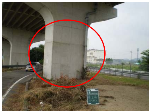
橋脚補強（RC巻立）【対策前】
