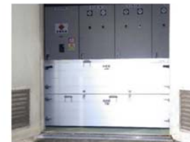
止水板による受変電設備への浸水対策
