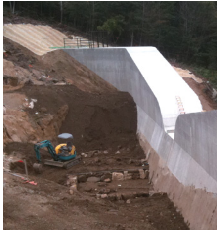
堰堤背後の埋め戻しが進む中野2号砂防堰堤工事(広島市安佐北区)
