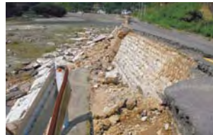
平成17年9月洪水の被害状況 広島市安佐北区安佐町大字飯室地先
