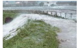
平成16年高潮による浸水状況 (広島市西区観音付近)
