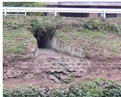
空石積護岸前面コンクリートの剥離
