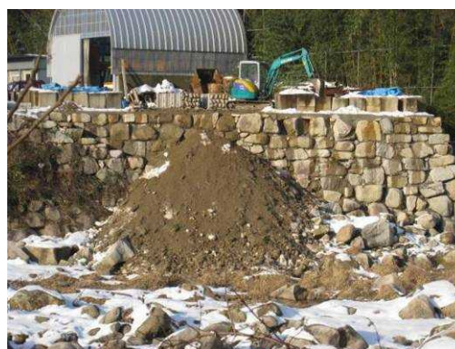
図 5-4-3 河川内への不法盛土の事例 (太田川)
