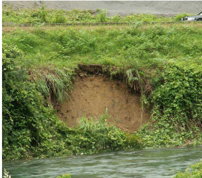
図 3-3-1 洗掘による護岸崩壊（対策済）
