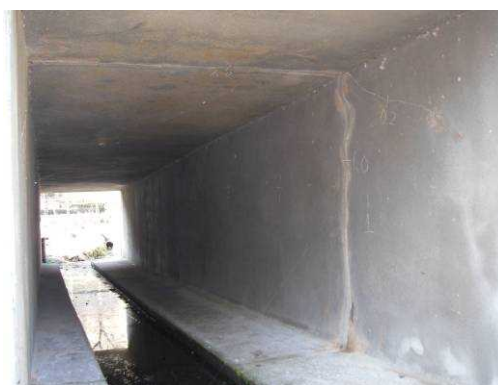
安条排水樋門（函内クラック）
