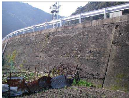
クラックが生じている護岸
