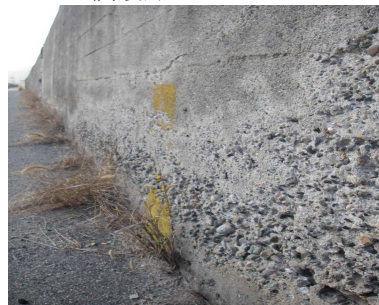
剥離損傷している波返工部材
