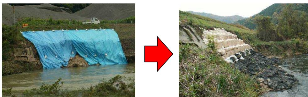
対策前 対策後 図 5-3-2 洗掘により護岸が崩壊した事例（前沢護岸）
