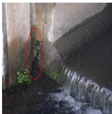
小瀬排水樋門（クラックから漏水）
