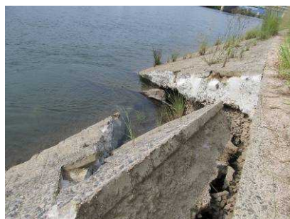
図 5-3-3 洗掘により低水護岸が侵食した事例（太田川：対策済）
