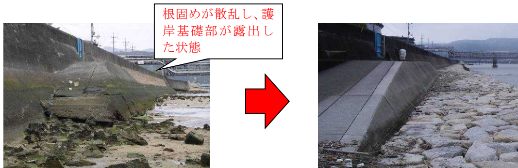
対策前 対策後 図 5-3-1 根固めが流出し、基礎部が露出した事例（和木護岸）
