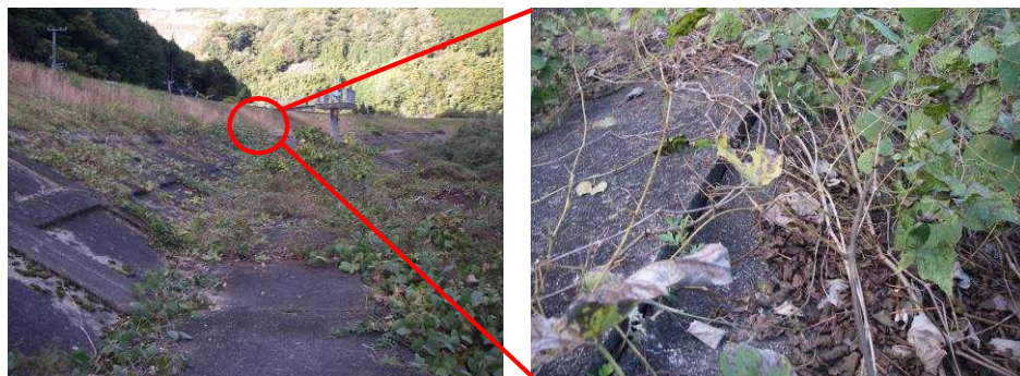
図 3-4-3 取付護岸のずれ (対策済)
