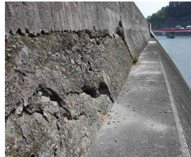
コンクリートのひび割れが生じている護岸
