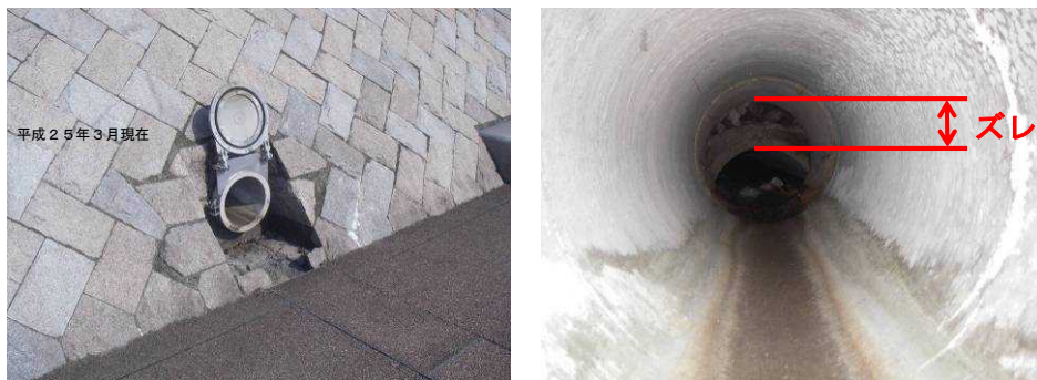
図 3-4-4 樋管のズレ等
