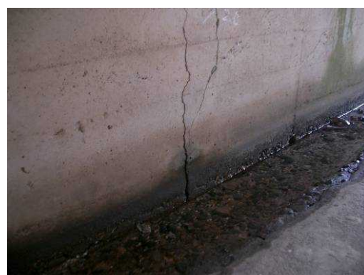
中津原排水樋門（函内クラック）
