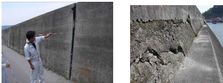
波返し工目地の開き コンクリートのひび割れ
