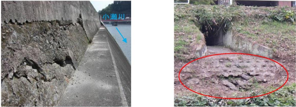
護岸の老朽化 補強コンクリートの剥離
