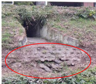
補強コンクリートの剥離
