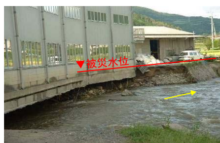
支川玖島川玖島地区の河岸侵食
