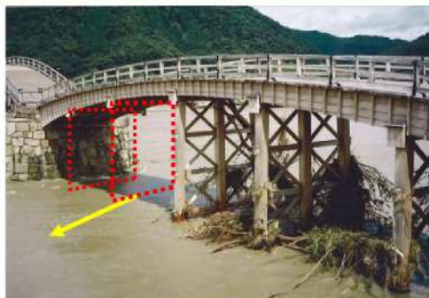
▲③錦川錦帯橋の橋脚の一部流失
