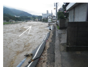
安佐北区可部地区の被害状況
