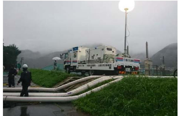
図 3.1.70 排水ポンプ車出動状況 (平成 30 年 7 月豪雨：奥迫川排水機場)
