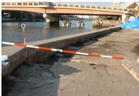
空洞化による天端の陥没(市内派川)
