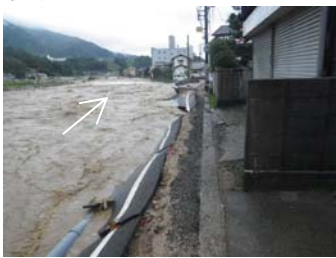
図 3.1.19 安佐北区可部地区の被害状況
