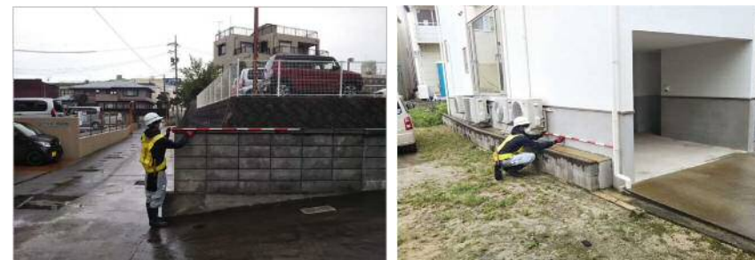
浸水状況(痕跡水位調査)
