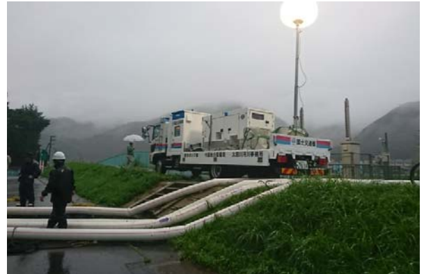
図 3.1.46 排水ポンプ車出動状況 (平成 30 年 7 月豪雨：奥迫川排水機場)
