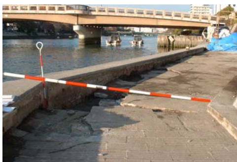
空洞化による天端の陥没(市内派川)
