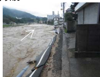
図 3.1.21 安佐北区可部地区の被害状況
