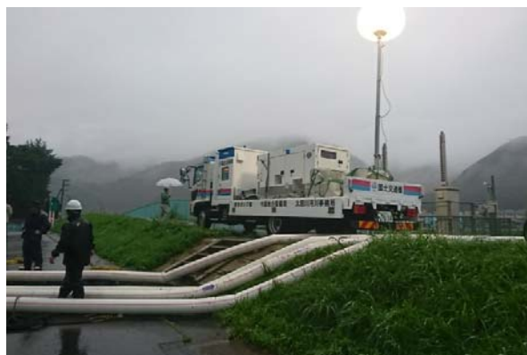
図 3.1.72 排水ポンプ車出動状況 (平成 30 年 7 月豪雨：奥迫川排水機場)
