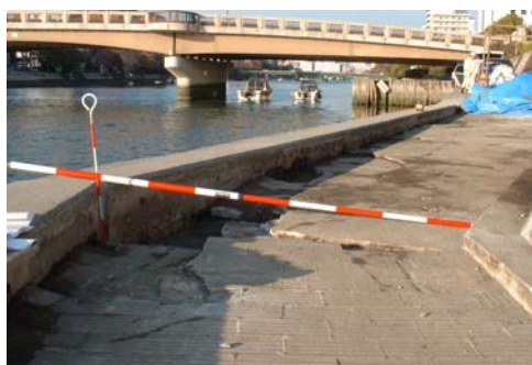
空洞化による天端の陥没(市内派川)
