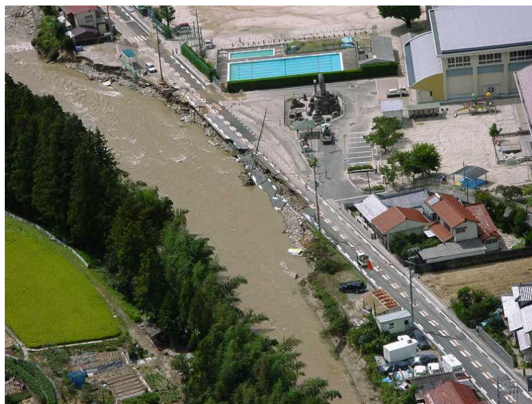
玖島川の被災状況(広島県廿日市市)
