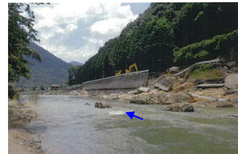
▲護岸の被災状況
