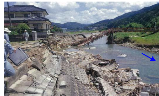
▲橋梁の被災状況
