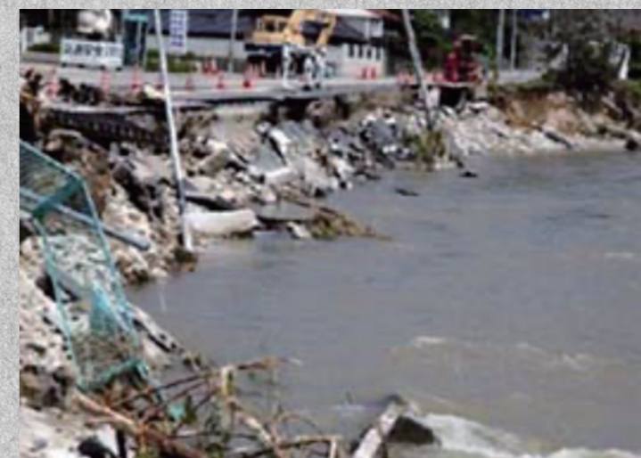
廿日市市友和地区・県道30号の崩落
