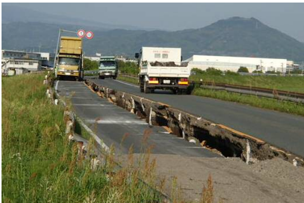
緑川堤防の被災状況(比較的軽微なもの)
